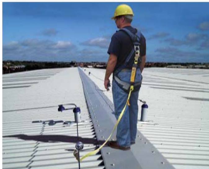
圖 7 屋頂職災預防
