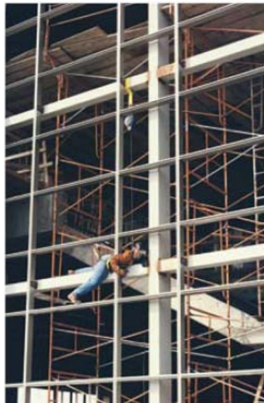
圖 9 施工架墜落職災預防
