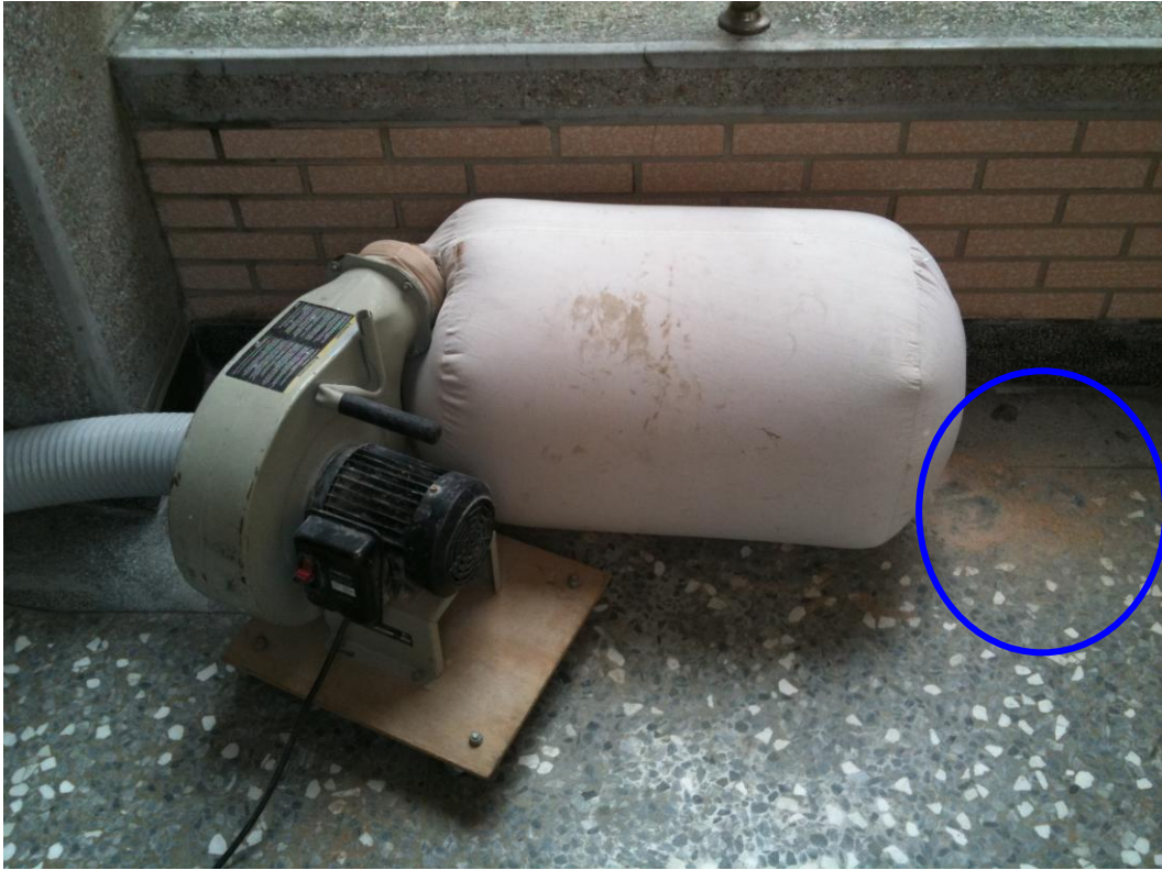
圖 3815 集塵濾袋粉塵漏洩狀況
