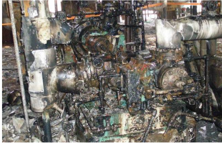
圖 5.3 第六蒸餾工場 P-603C 第一側迴流泵浦軸封洩漏引起火警
