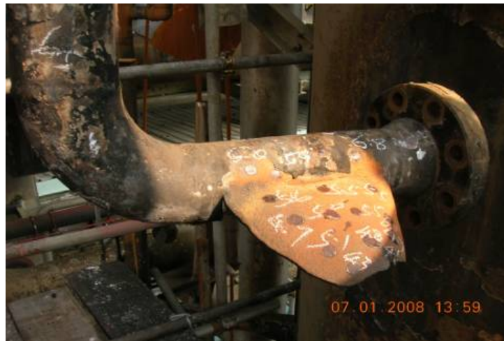
圖5.6 工場事故地點外觀圖(D-2111安全閥水平管爆裂)
