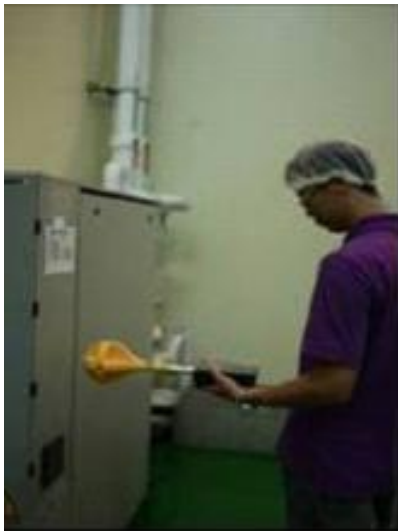
塑膠吹瓶機 - 總電源配電箱
