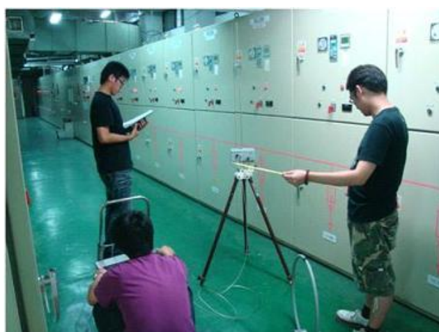
電力機房 - 電氣箱前端通道
