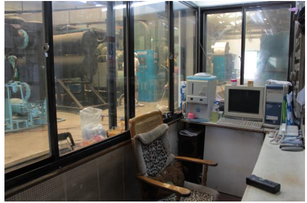
空壓機值班室
