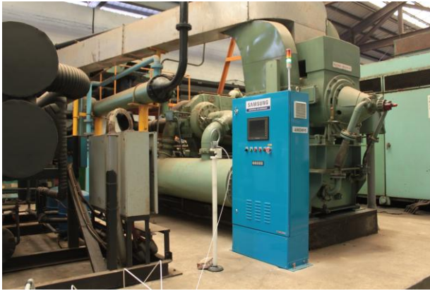
空壓機及控制面盤
