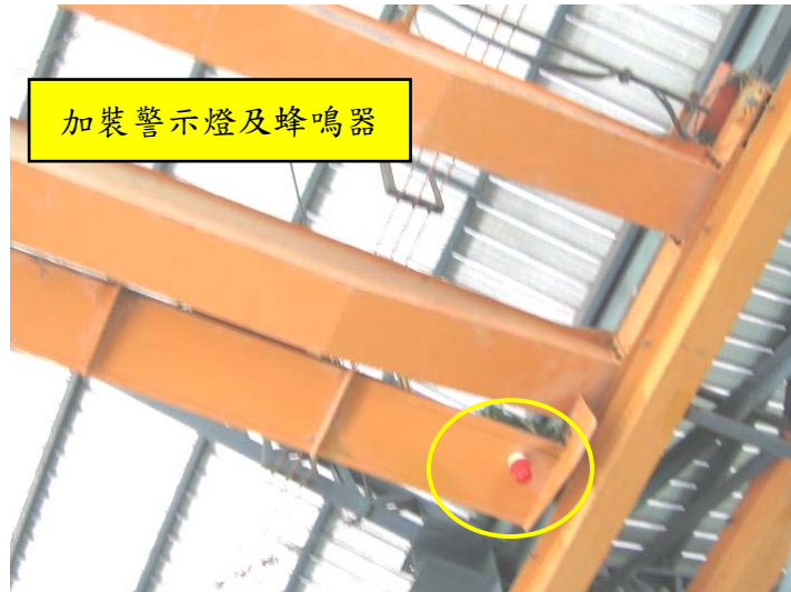
圖 62 固定式起重機標裝設蜂鳴器及警示燈.
