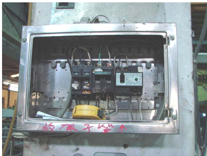
圖 80 電氣開關箱現場缺失.
