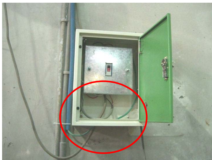
圖 81 電氣開關箱接地.
