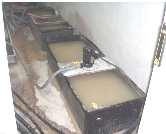
圖 70 鑽孔機抽水馬達未接地.
