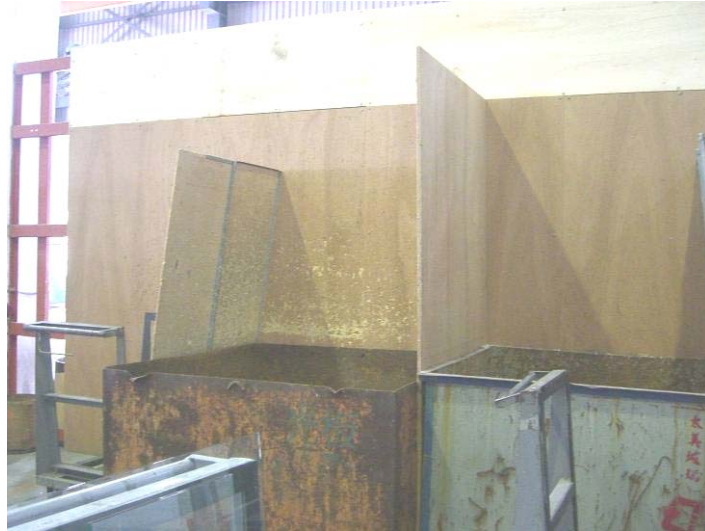
圖 67 廢玻璃桶缺失改善措施.
