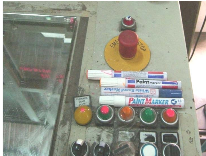
圖 90 緊急制動開關未設置防誤觸裝置.
