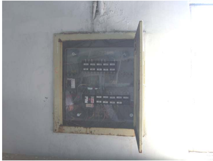
圖 82 電氣開關箱裝置中隔板.
