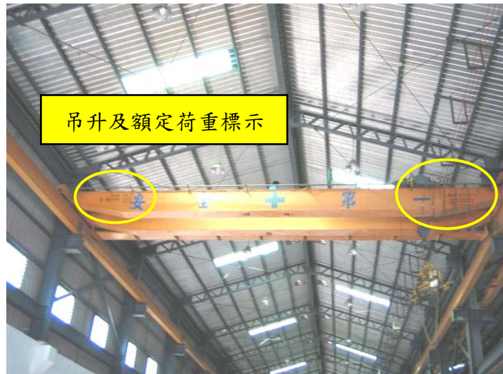
圖 60 固定式起重機標示吊升及額定荷重.
