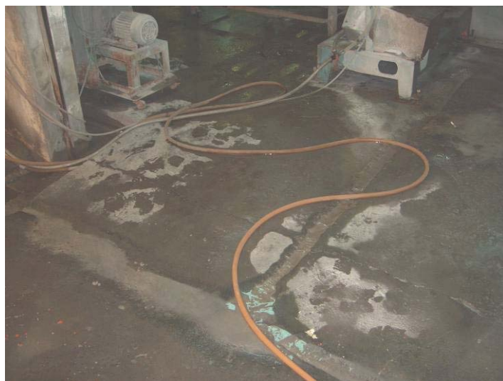
圖 74 鑽孔機污水未妥適處理.
