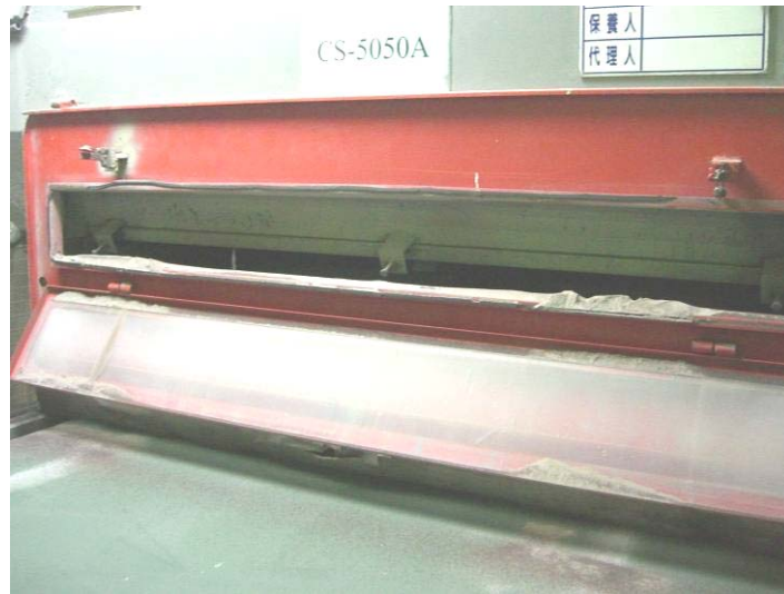
圖 78 噴砂機現場缺失.
