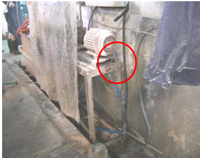
圖 72 鑽孔機抽水馬達缺失改善措施.
