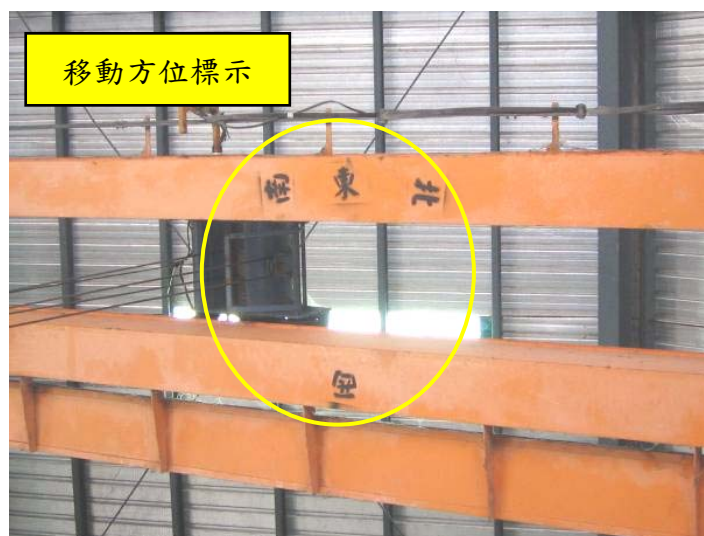
圖 61 固定式起重機標示移動方向.
