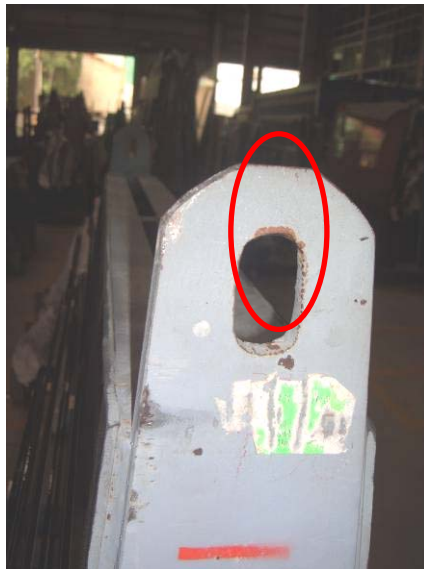
圖 57 玻璃原片放置架現場缺失。
