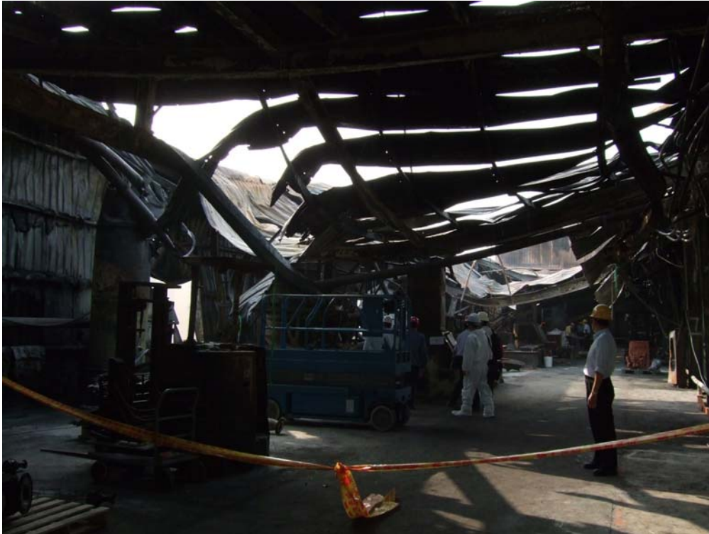
圖 5 事故廠區受大火嚴重破壞
