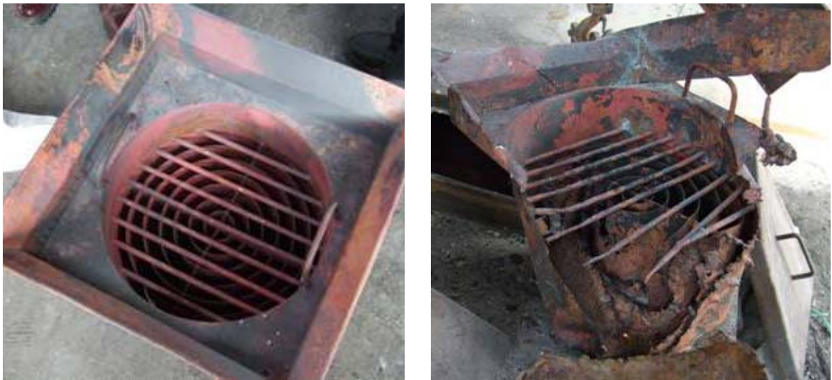
圖 7 銅質環狀漏斗燒毀貌
