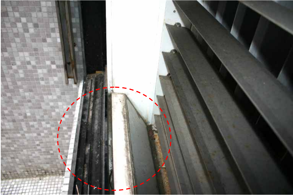
圖18 吸氣式開迴路風洞：出口修改前底部傾斜突出部位特寫
