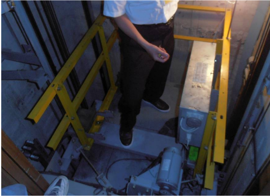
圖 58 工作平台在車廂頂的周邊護欄
