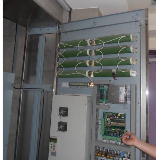
圖 56 控制箱設在乘場門旁上鎖的機櫃中
