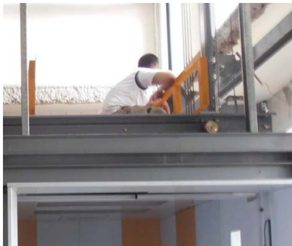
圖 26 維修人員在橫梁上蹲下時可以靠在圍欄上
