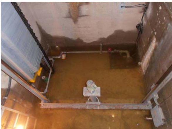
圖 72 可以看到供進入機坑的鋼梯
