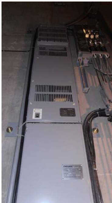
圖 68 控制箱安裝在升降路內靠近頂部的 位置
