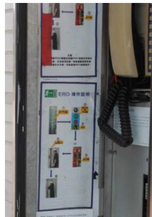
圖 81 控制箱的門上有緊急救援的操作步驟標示
