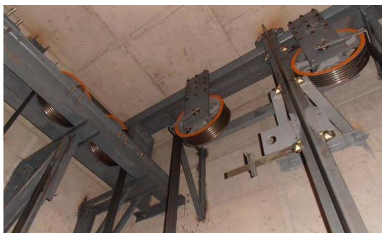
圖 54 轉向滑輪支撐梁透過角鋼架固定到升降路牆壁上
