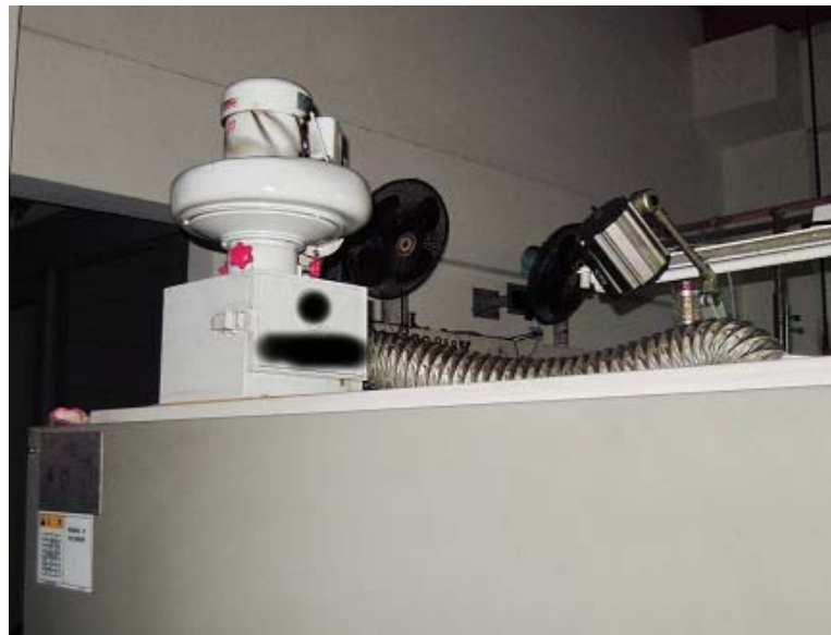
圖 18 B1 廠的立式高壓二段式油霧回收機
