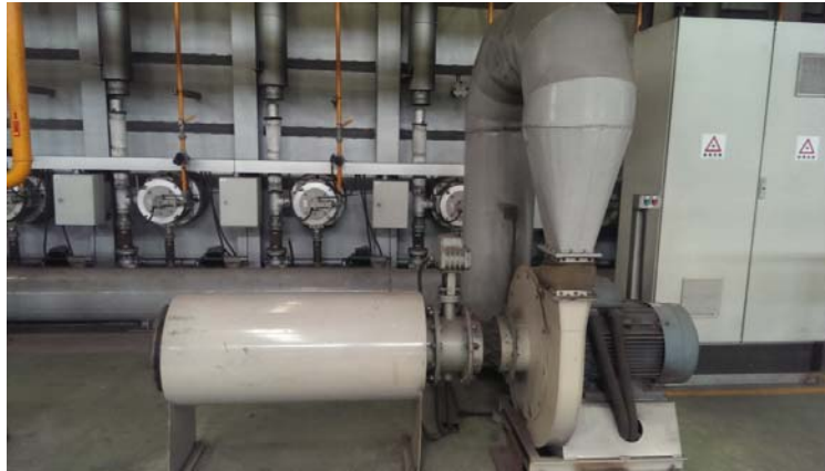
圖 45 加熱爐送風機
