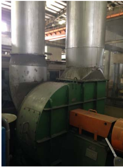
圖 41 除塵設備風機
