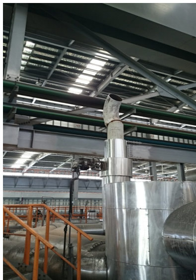
圖 44 環型加熱爐頂部之排氣管
