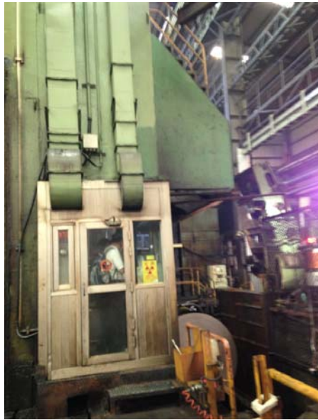
圖 52 冷軋控制室(有洩漏音)
