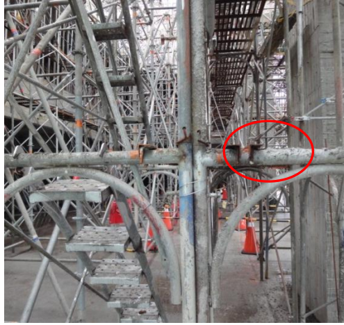
圖 45 施工通道之踏板無設置防脫落勾
