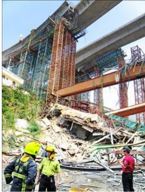
圖 19 北山交流道崩塌現場
