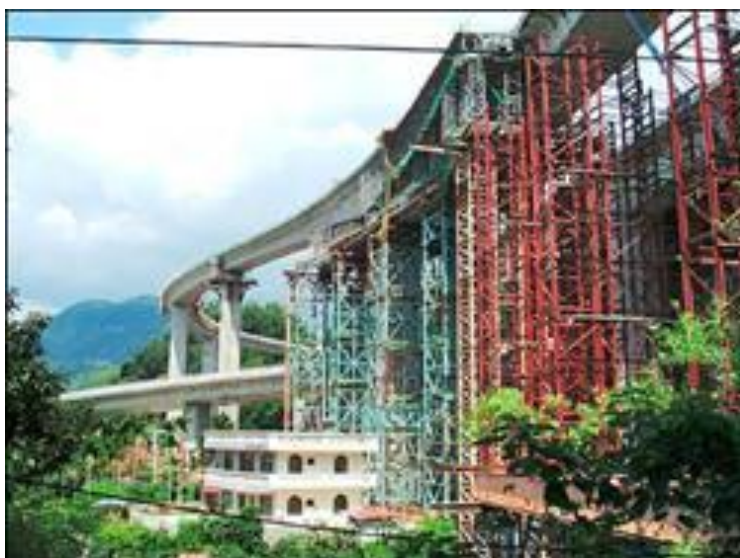
圖 18 北山交流道未發生工安意外前的現場圖
