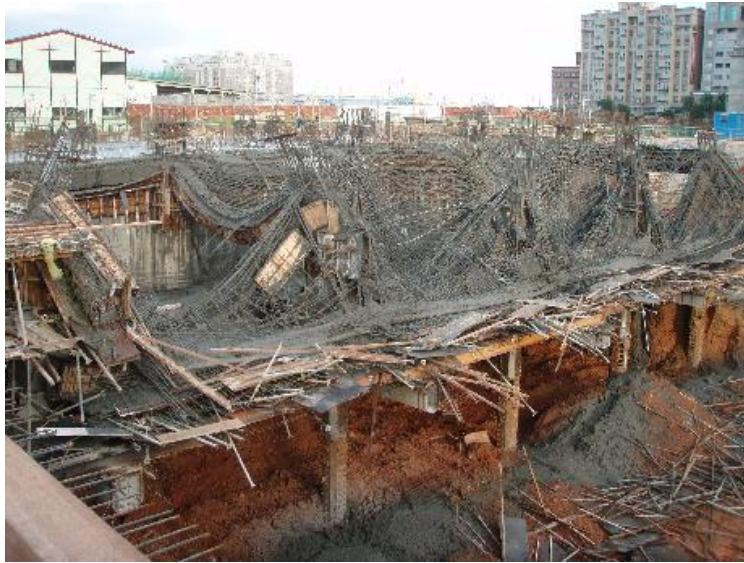
圖 17 林口某建築工地模板支撐崩塌
