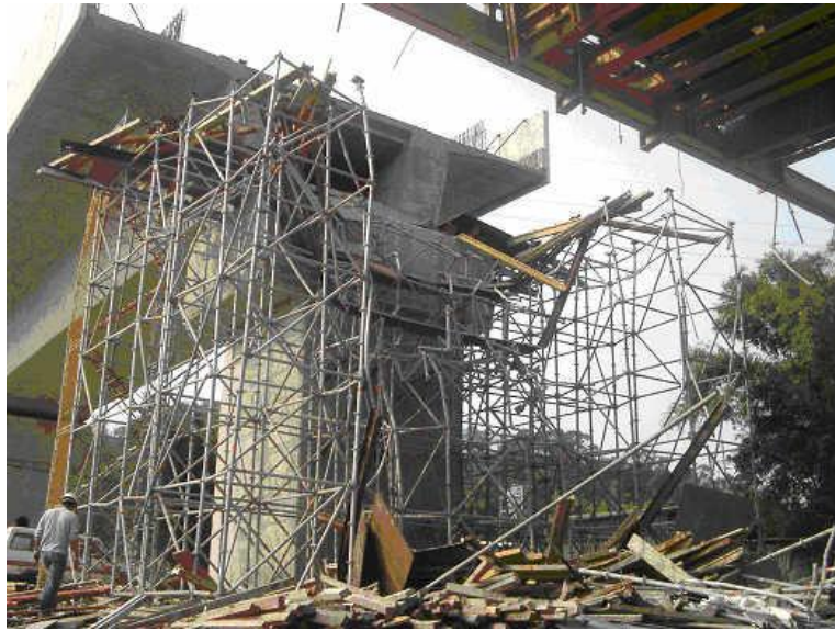
圖 16 橋塊腹版下 20 支鋼管支撐架皆遭壓垮
