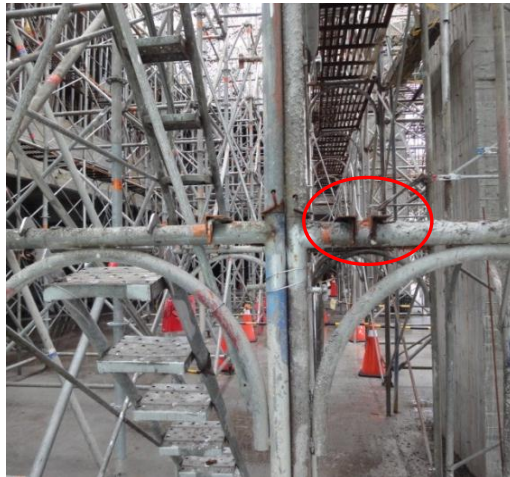
圖 8 施工通道之踏板無設置防脫落勾
