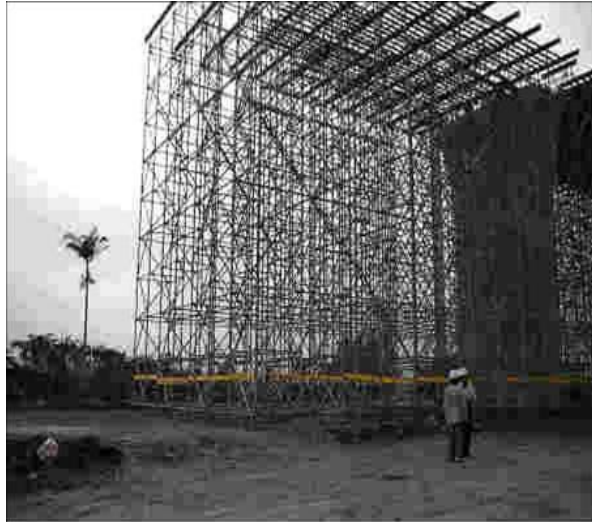
圖 14 模板支撐架，未設上下設備及安全防护
