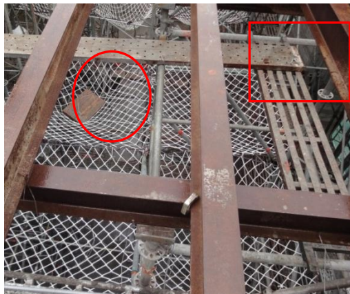
圖 46 安全網上的鐵件及通道設置問題
