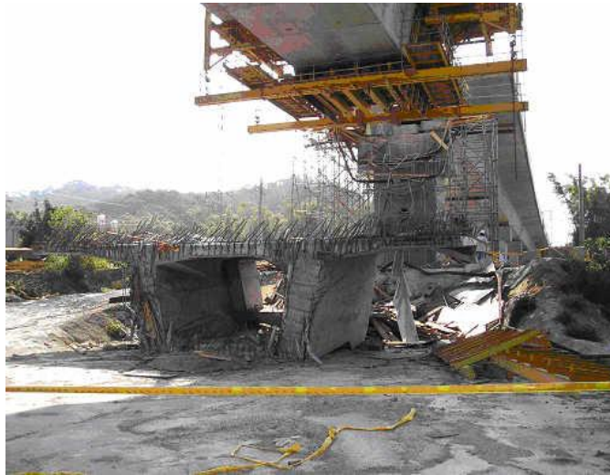
圖 15 橋塊前方之鋼筋皆已彎折
