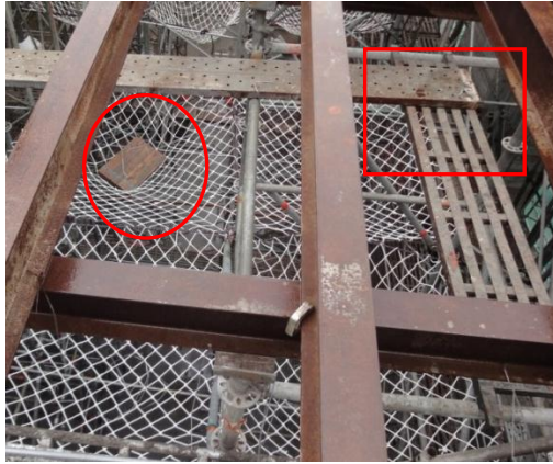
圖 9 安全網上的鐵件及通道設置問題
