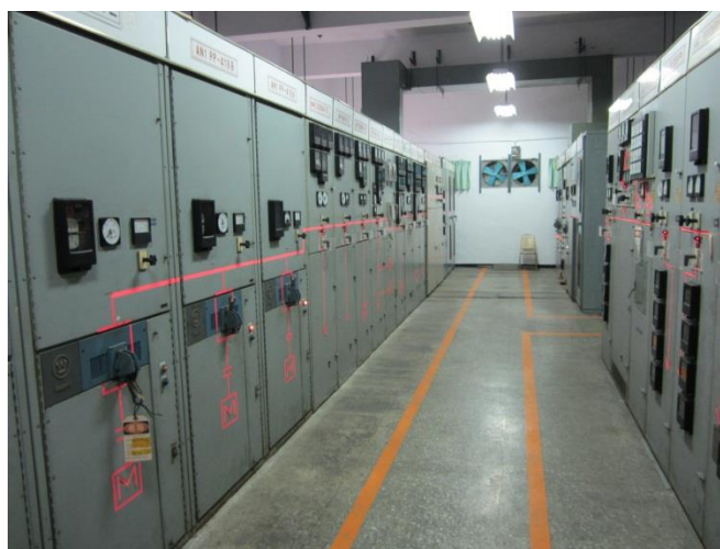
圖 59 廠家 F 變電室內規劃之步道
