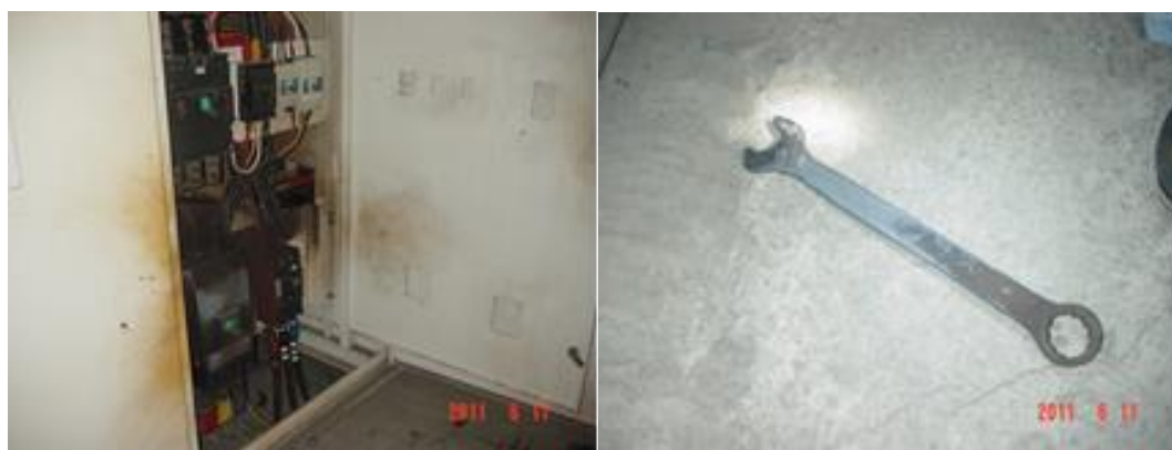
圖 6 事故配電箱及使用之梅開板手
