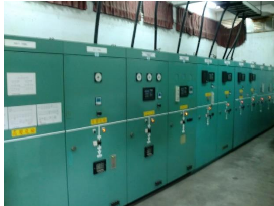
圖 53 廠家 E 之電氣室全景圖
