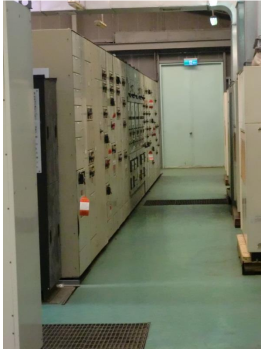
圖 16 廠家 A 之配電盤全景
