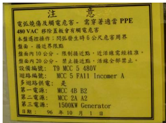
圖 17 廠家 A 弧光危險警告標示圖
