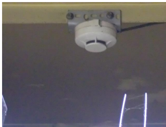
圖 58 廠家 E 配電盤使用之偵煙裝置
