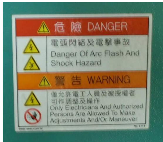
圖 56 廠家 E 配電盤使用之符合 NEC 規範之警告標籤
