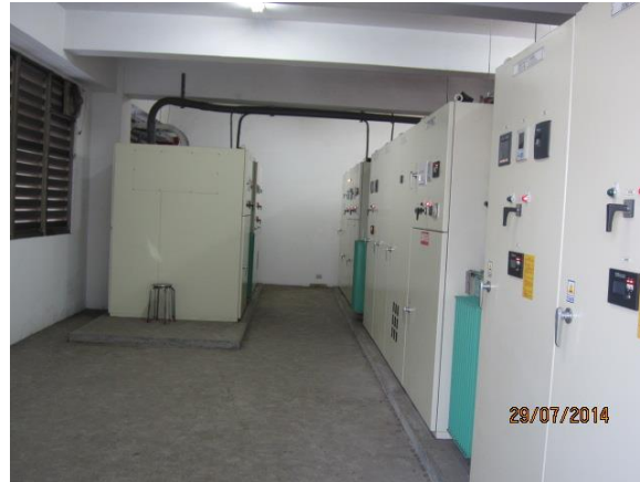
圖 48 廠家 D 之配電盤外觀圖
