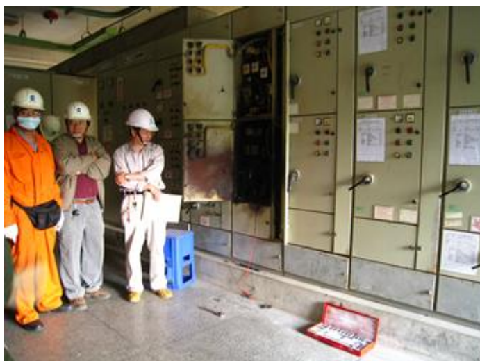
圖 5 污水處理廠開關盤電弧閃光事故
