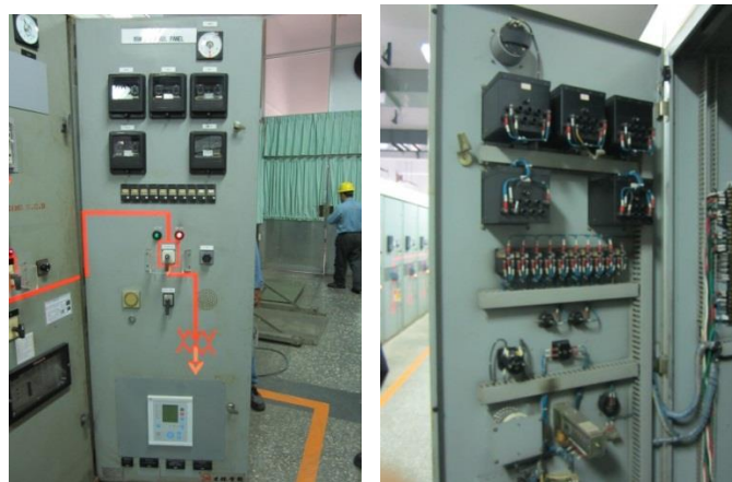
圖 62 廠家 F 使用之 69kV 等級配電箱
