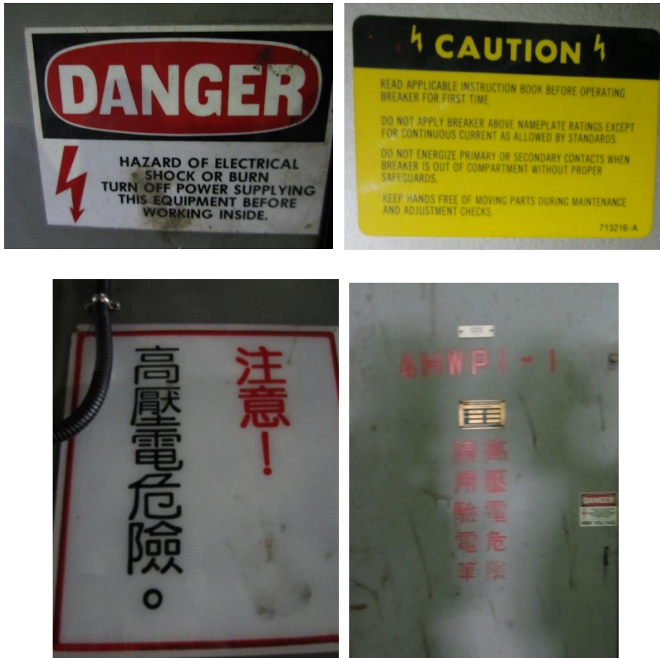
圖 45 廠家 C 配電盤上使用之各種警告標籤
