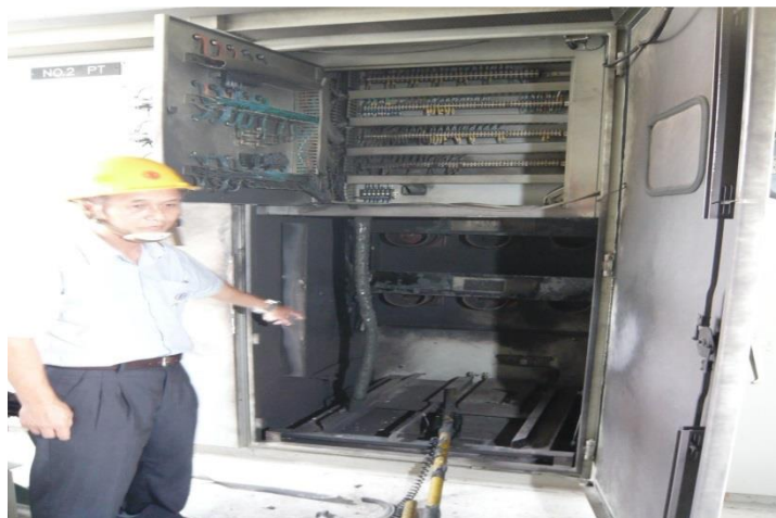
圖 4 台電裝甲開關箱電弧閃光事故
