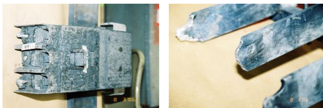
(a)毀損嚴重的斷路器
