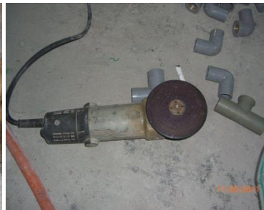
現場使用手持型電動砂輪機未設護罩。
