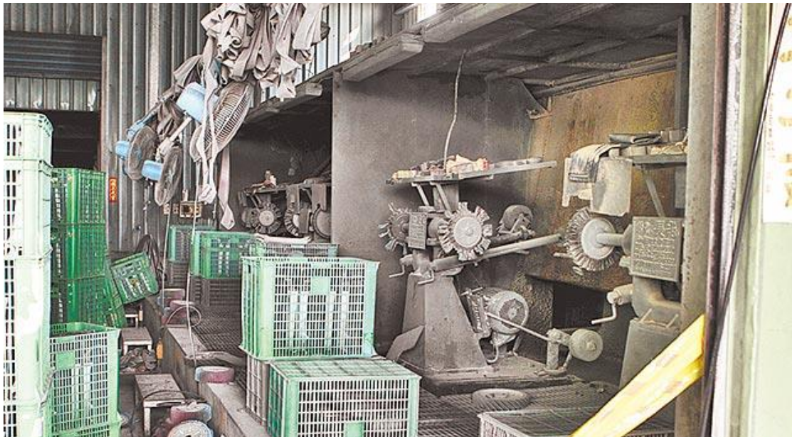
圖 5 2014 年 11 月 01 日彰化縣某腳踏車工廠發生金屬粉塵爆炸之事故 [10]
